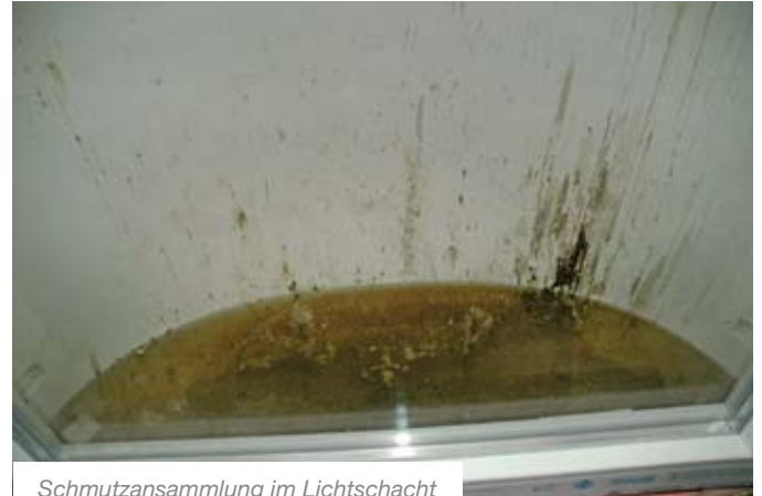
Schmutzansammlung im Lichtschacht
