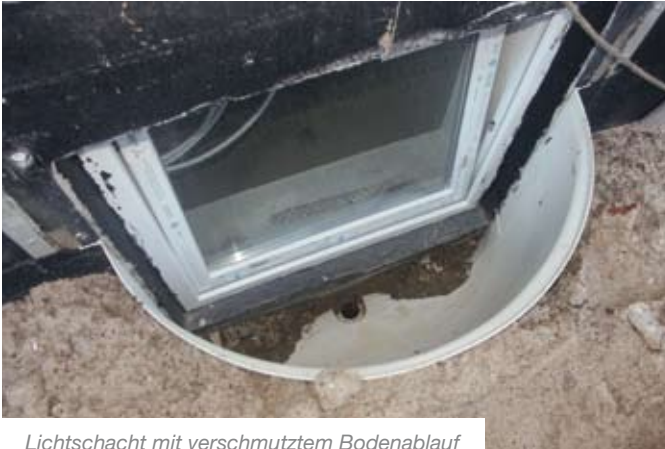
Lichtschacht mit verschmutztem Bodenablauf
