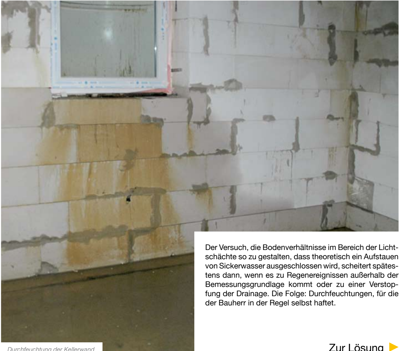
Durchfeuchtung der Kellerwand
